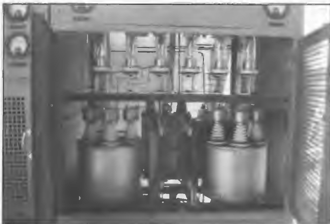
(b) Rectifier unit.
