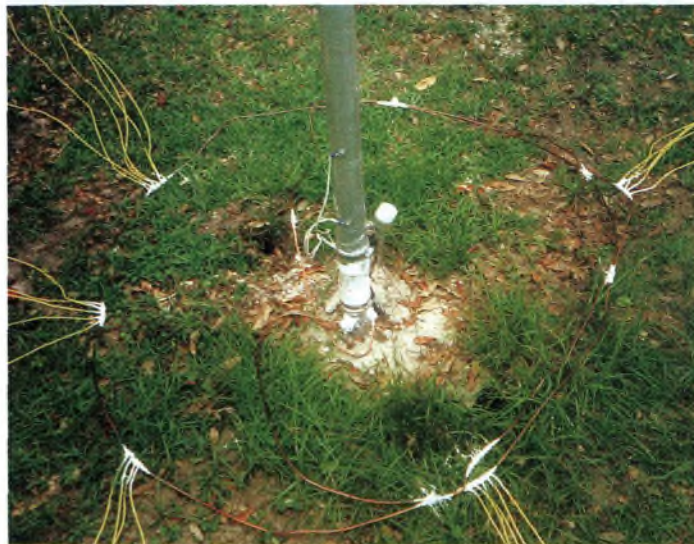
Le plan de sol. La boucle est reliée au support et aux radiants. Il est utile de protéger les connexions de masse contre la moisissure.
