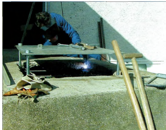
Une fois terminées les soudures, l'intérieur du quai sera rempli avec 3 m 3 de béton.
