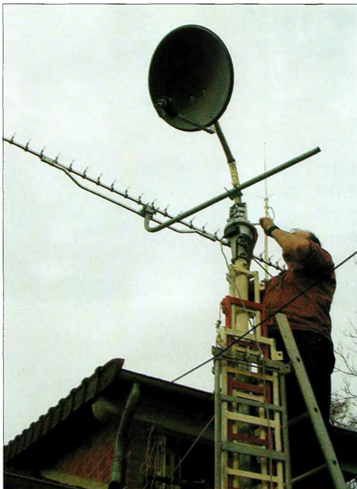
Les mâts et pylônes sont d'une grande qualité de fabrication.
