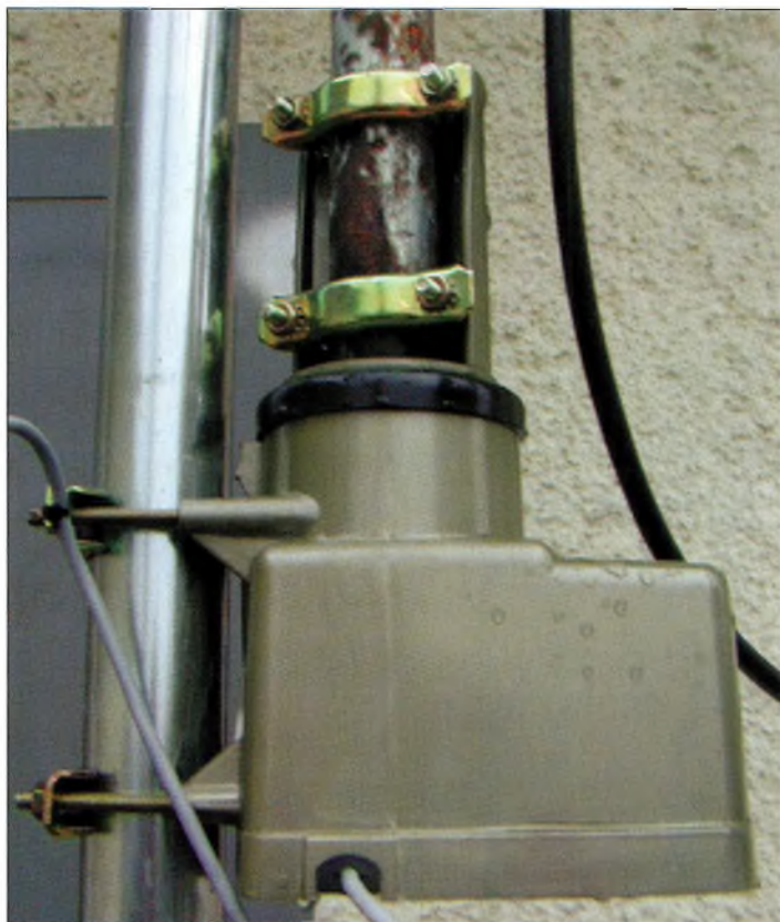
L'installation du moteur est déportée par rapport à son mât.
