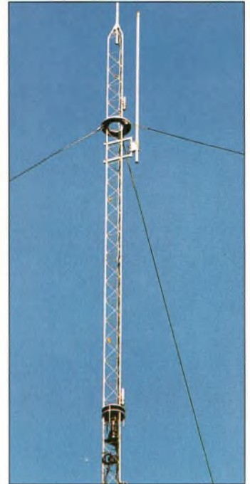
Photo 6- La partie tournante du pylône de l'auteur.
