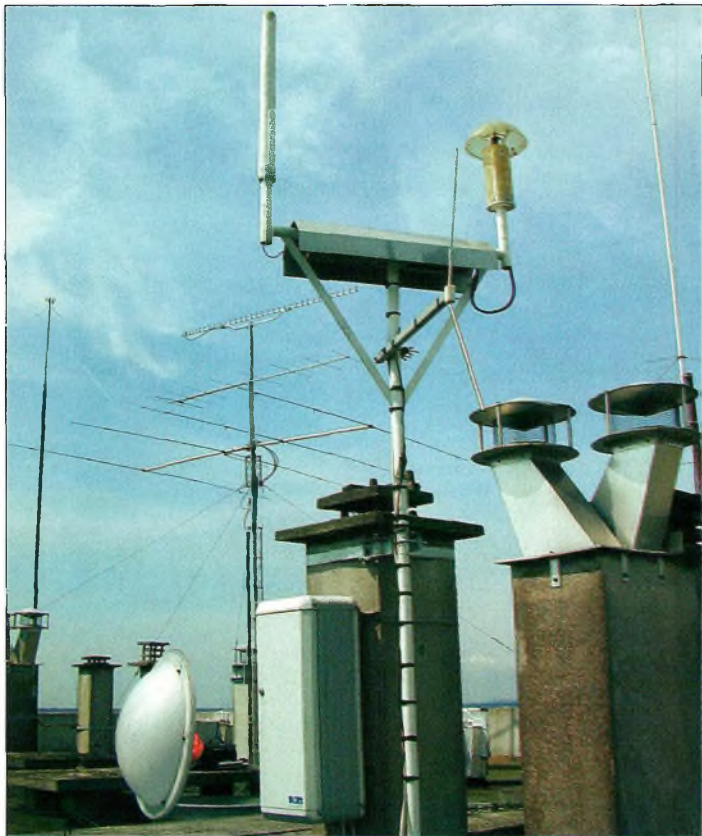
Notez sur le Y de maintien, l'antenne à fentes 10 GHz à gauche puis de l'autre côté, la Big-wheel centrée sur 1 255 MHz. Entre ces deux antennes, l'aérien qui sert à la voie de service.
