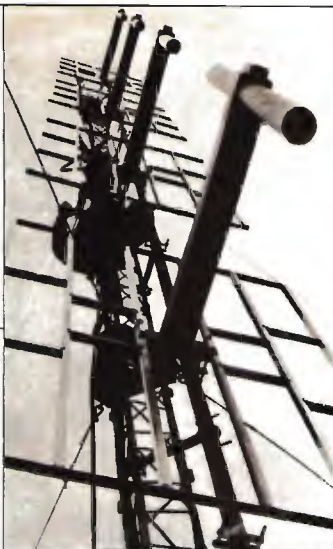
PANNELLO A DP 200 7 DB 170° ORIZZONTALI LARGA BANDA 3 kW 50 A
