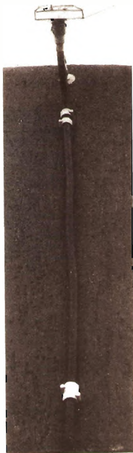
Particolare dell'attacco al cornicione del tetto del centrale del dipolo per gli 80 m.
