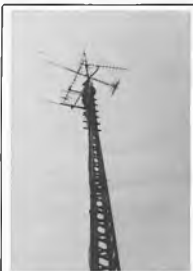
Zendmast Radio Montebaldo, waar via gerichte antenne het signaal van de (5 x) 2 kW zenders vertrekt, bovenop verschillende hergotoppen.
