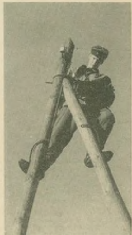
Eine Sprechstelle des Grenzmeldenetzes ist ausgefallen. Nach intensivem Suchen hat der Nachrichtentrupp den Fehler gefunden. Der Unterfeldwebel klettert selbst auf den Mast, um den Schaden zu beheben
