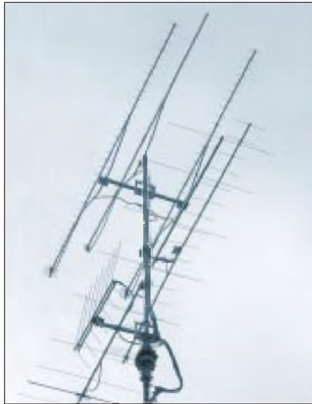
Bild 7: ATV-Antennenanlage von DJ6PI
