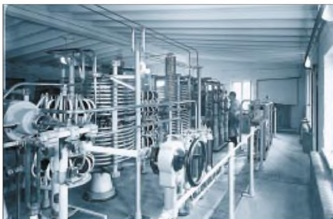
Bild 2: Ansicht der 100-kW-Mittelwellen- Sendeanlage des RIAS in Berlin-Britz aus den 60er Jahren Foto: Telefunken/RIAS
