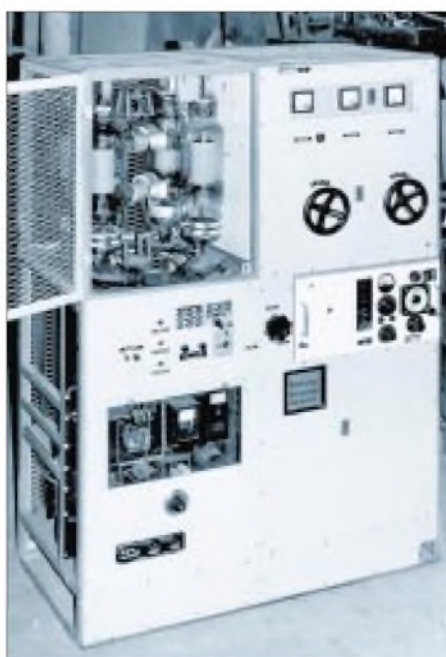
Bild 12: Gesamtansicht des 3-kW-Störsenders Fotos: J. Kullmann
