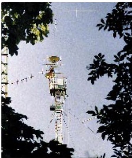
Die Satellitenanlage der Lampertheimer Klubstation DL0WW Foto: OV Lampertheim
