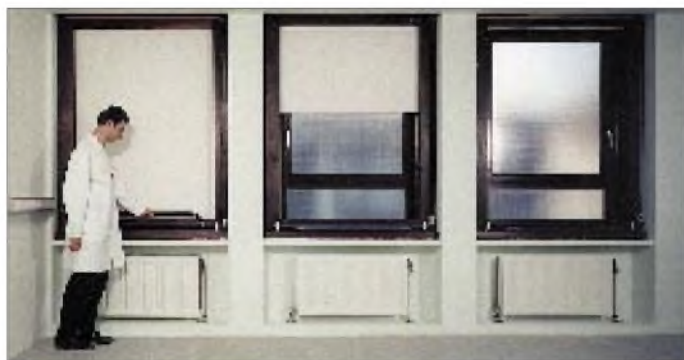
Fertig ausgebaute Datensicherheitsraum mit drei Shieldex-Rolls-Fenstern
