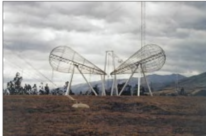
Auf Schienen kann diese Antenne in die gewünschte Richtung gedreht werden, um die bis zu 500 kW Sendeleistung abzustrahlen.
