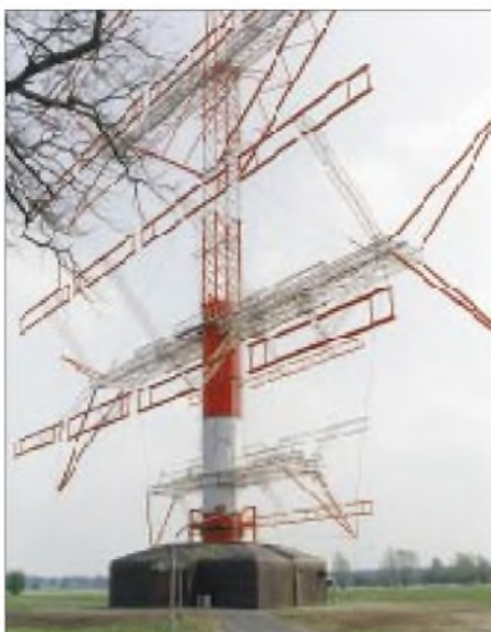
Nahaufnahme einer Drehstandantenne. Der mit Kupferblech verkleidete Sockel bietet Platz für Sender, Kunstantenne und Werkstatt/Ersatzteillager.
