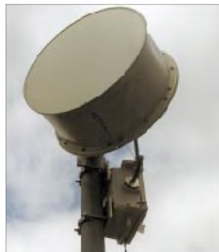
Blick über die RiFu-Antennen aus 40 m Höhe. Nur in solchen Höhen läßt sich der gewünschte Rundumblick realisieren.
