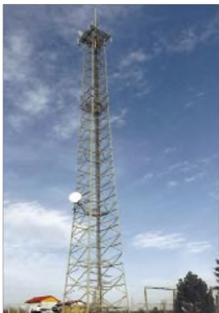
70-m-Mast eines Energieversorgers: Über solche Funkstrecken werden beispielsweise Meßwerte übertragen und Umspannwerke ferngesteuert.
