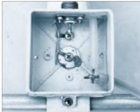
Bild 3: Die Ausführung der Koaxialkabel-einspeisung
