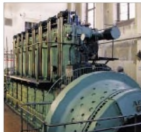
1000-PS-Dieselmotor im Maschinenraum des Senderhauses 1
