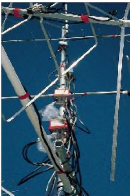
Die UKW-Antennenanlage aus einer anderen Perspektive gesehen: irgendwie verrückt. Naja, es mußte ja nur drei Wochen funktionieren ... Fotos: DF2SS
