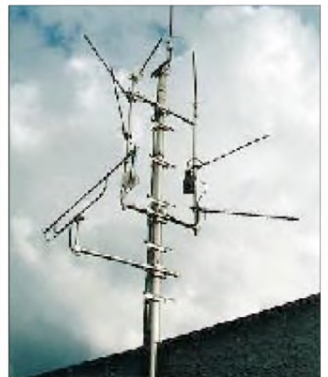
OE9XPR auf dem Dach der Pfänderbahn-Bergstation: für jede Datenfunkstrecke wurde eine eigene Richtantenne montiert. Foto via OE6GLD
