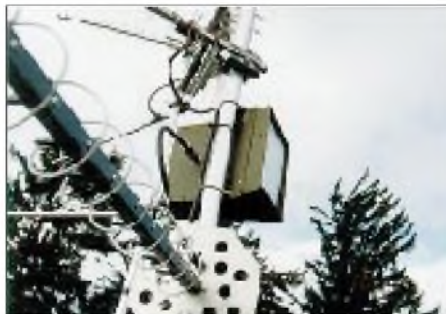
Blick auf die Antennenanlage von OE9XPR
