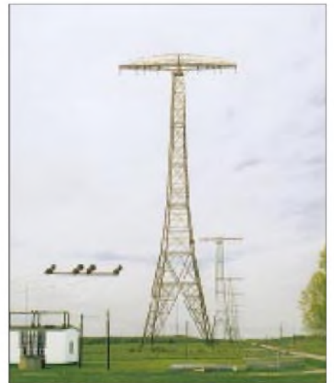
Das Antennensystem wird von sechs Gittermasten getragen, vorn links die Einspeisung und die Abstimmspule für den vorderen Vertikalstrahler. Fotos: Autor
