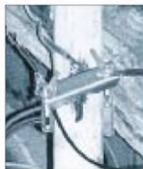
Bild 3: Die ungeeignete Antennenschelle bietet nicht genug Auflagefläche (VDE 0855 empfiehlt 100 mm 2 ), um das Erdungskabel korrekt mit dem Mast zu verbinden.
