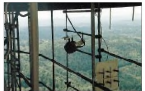
Linkantennen von DB0AAC zu DB0GE (Scheibenantenne) und DB0KLN (Flächenantenne).
