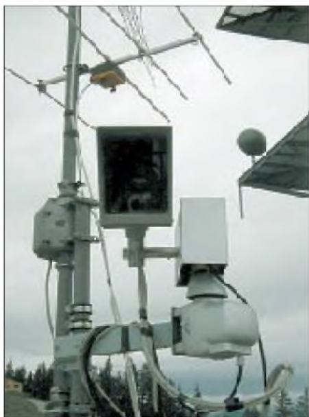
Antennenanlage und Steuergeräte des ATV-Relais
