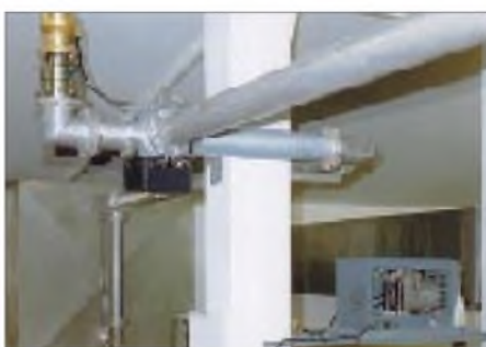
Bild 7: Umschalter für Antenne/Konstantantenne, unten rechts der Kompressor für die permanente Trockenluft-Spülung der Koaxialleitung
