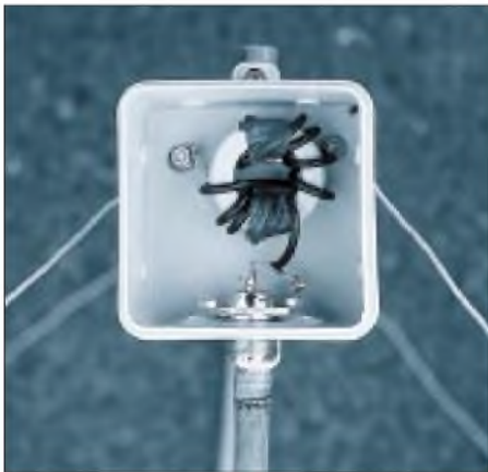
Bild 6: Der Anschlußkasten mit dem Balun
