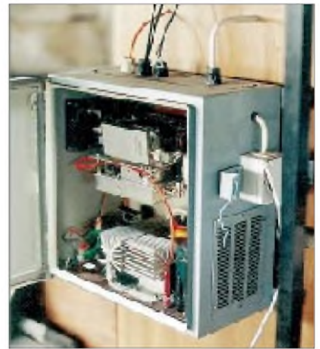
Versorgungsschrank bei DB0FDD (u.a. Netzteil)
