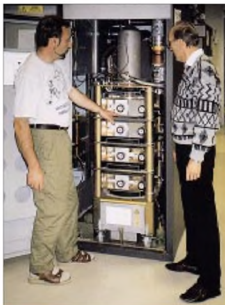
Die acht TV-Klystrons der vier Sender liefern insgesamt 500 kW. Die Impulslänge kann zwischen 1 \mu s und 2 ms liegen.
