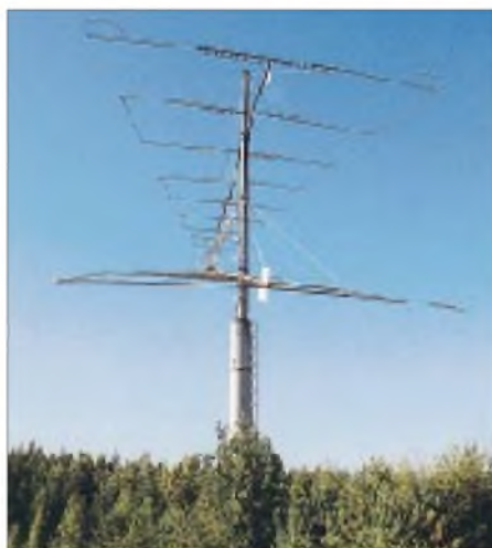
Eine 40 m hohe drehbare Logperiodic dient als Reserveantenne Fotos: DL6AKC
