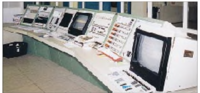
Kontrollraum der Sendestelle Pori
