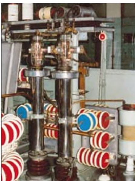
Ein Gegentaktzweig der 250-kW-Endstufe; das am linken Bildrand erkennbare Kuchenblech gehört zu einem Plattenkondensator.
