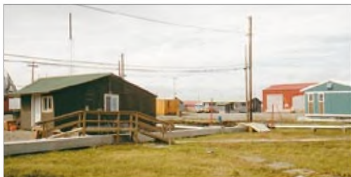
Anfänge der Kanalisation: In einem Teil des Dorfes überirdisch verlegte Abwasserleitungen (wegen des Permafrosts) mit Brücken für ATVs und Fußgänger
