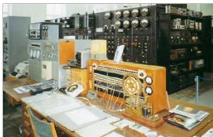
Bild 7: Der Funkplatz und die große Schaltanlage Fotos: G. Schenz
