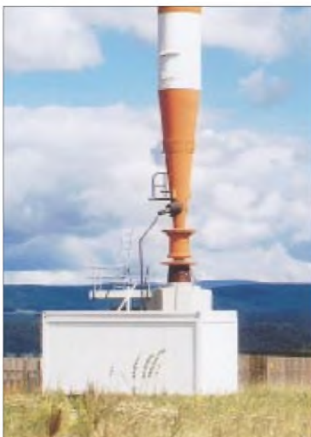
Container mit Antennenanpassung der direkt gespeisten Vertikalantenne
