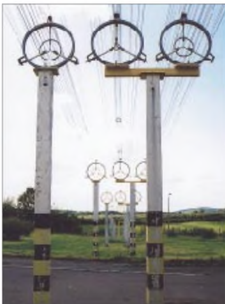
Speiseleitung und Transformationsleitung für die Quadratantenne
