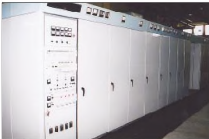
Der Sender PSW 1000 besteht aus zwei baugleichen 500-kW-Blöcken in Form solcher „Schrankwände“
