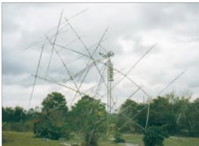
Bild 4: In den USA gilt der Spruch: „Wenn die Antenne länger als ein Jahr halt, war sie nicht groß genug.“ Dieses Exemplar von W4ZD war groß genug ...
