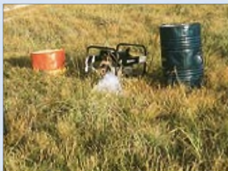
Die 5,5-kVA-Diesellaggregate waren abseits aufgestellt und liefen die ganze Zeit durch
