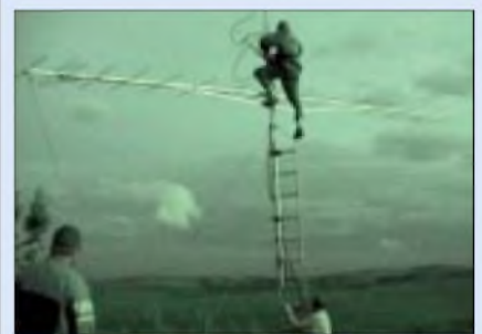
Jussi, OH6ZZ, bei Arbeiten am Powersplitter.
