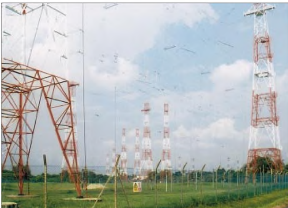
Vorhangantennen auf dem Gelände der Relaisstation
