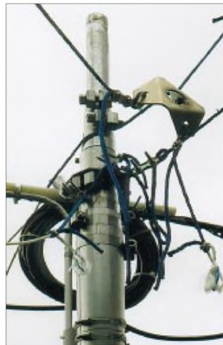
Bild 5: Blick auf den eingefahrenen Mast mit der Verlängerungsspule aus Koaxialkabel. Hier ist der Mast zu weit eingefahren, die äußere Mastschelle klemmt nicht nur das nächstkleinere Segment fest, sondern auch noch das übernächste. Die Schlitzte dürfen sich eingefahren nicht überlappen!
