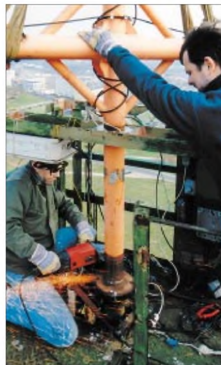
Bild 6: Rainer, DL1AUZ, und Steffen, DL4ALB, trennen am Fuß des Standrohrs der 3-El-40-m-Quad das angeschweißte, teilweise zahnlose Zahnrad ab, während die Gurte des Krans diese Prozedur stabilisieren. Die in 30 m Höhe liegende Plattform für diese Antenne erlaubt immer wieder einen schönen Blick nach Ilmenau, hinein in der Thüringer Wald.
