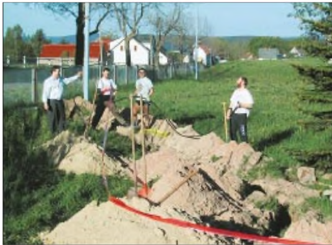
Bild 1: Nach langem Warten und viel Mühe beim Grabenausheben konnte im Mai das neue Stromzuführungskabel in die Erde gebracht werden. V.l.n.r.: Lothar, DL3TD, Steffen, DL4ALB, Rainer, DL1AUZ, Ben, DL5ANT
