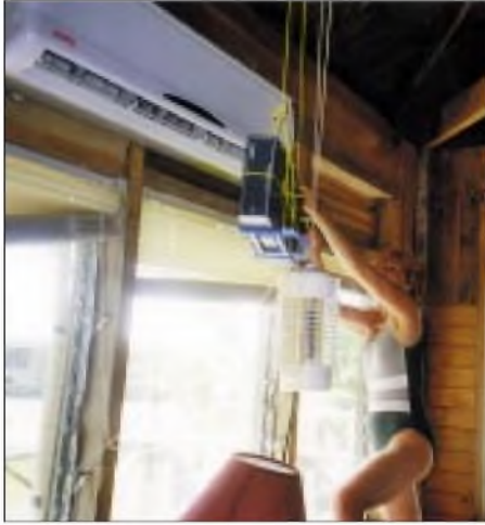
Kühlung ist alles! Hier hat die XYL das Schaltenteil direkt vor die Klimaanlage gehängt.
