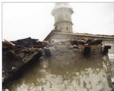
Nach dem Sturm: Es fehlten fast alle Dächer.
