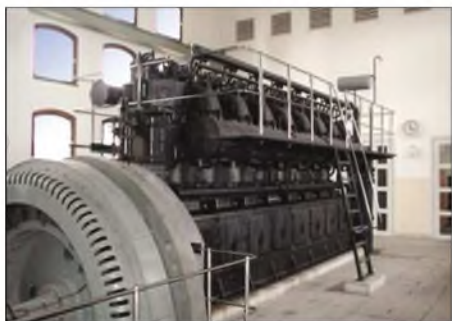
Der 1000-PS-Dieselmotorgenerator aus dem Jahr 1939
