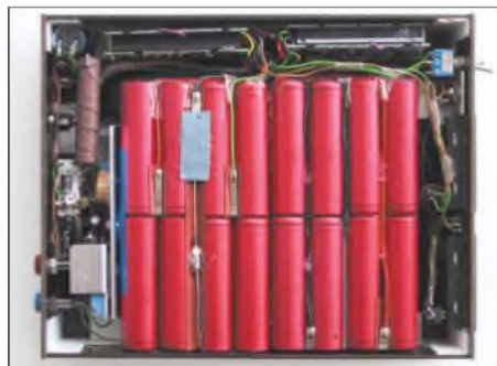
Bild 6: Fertig aufgebaute Stromversorgungsbox mit 32 Li-Ionen-Zellen, links der Spannungskonverter mit Ladewiderstand, oben die originale Ladeelektronik, rechts die digitalen Messinstrumente Fotos: DL1AKE
