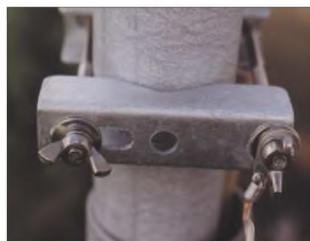
Bild 3: Der Balun lässt sich mit einer mitgelieferten Mastschelle befestigen, die auch für die Kontaktierung der Erdungsleitung sorgt. Fotos: DL2IAN
