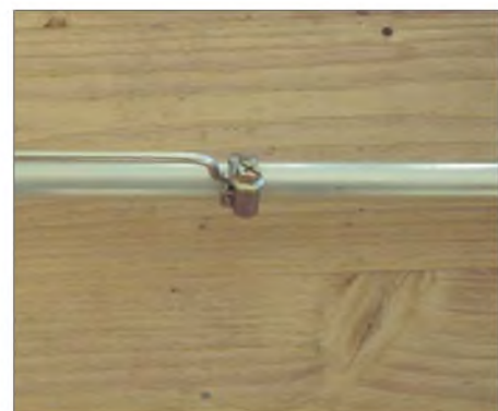
Bild 8: Übergang der Phasenleitung zum Aluminiumrohr mittels Schlauschelle
