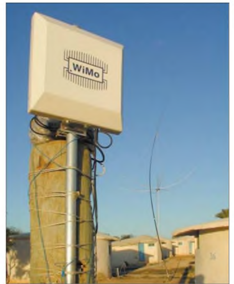
Bild 2: WLAN-Access-Point an einem Pfahl im QTH2
