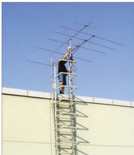
Montage des 5-Ele.-Beams für 6 m und der 9-Ele.-Yagi für 2 m
