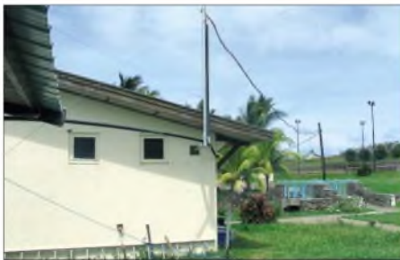
Die Stromversorgung der Stationen wurde durch eine eigens für uns errichtete 44-KW-Leitung sichergestellt
