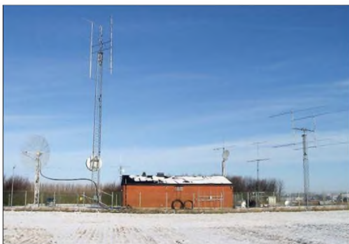
Die imposanten Antennenanlagen (u.a. Gruppen für 2 m und 70 cm sowie 4,5-m-Spiegel) von SK7MW in Süd-schweden (JO65). Foto: SK7MW
