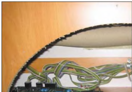
Länger gehts nicht: Kabelwirrwarr hinter dem Kontroll-Panel
