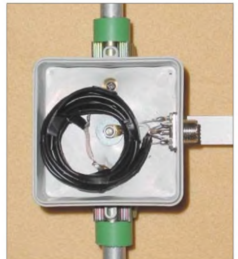
Bild 9: Anpassleitung als Kabeldrossel aufgewickelt
