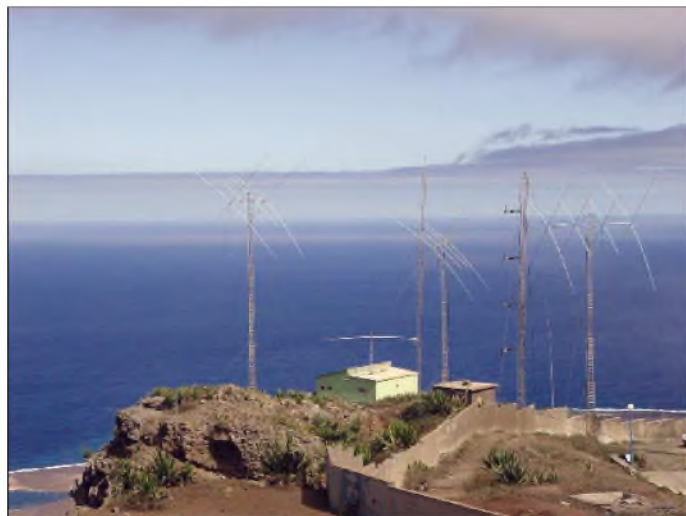
Die umfangreiche Antennenanlage von D4B auf den Kapverden – OP 4L5A wird zum CQ WWDX SSB und CW 2004 unter D4B von dort funken.
