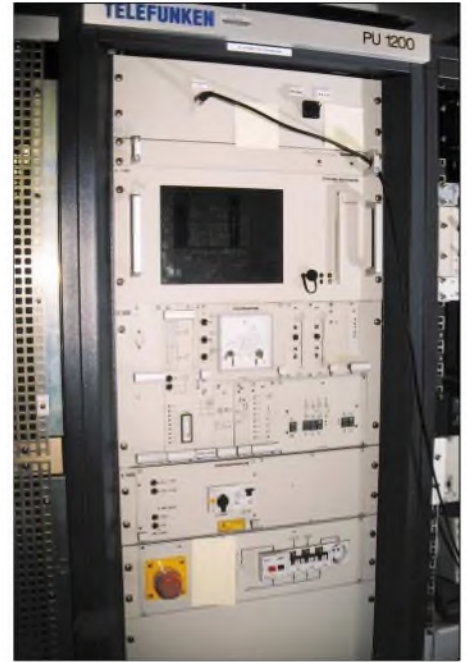
Steuerteil des von Telefunken hergestellten 1-MW-Senders TRAM 1000S
