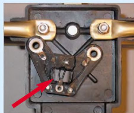
Bild 9: Im Anschlusskasten des Dipols befindet sich ein Symmetrierglied, das für den Umbau zu entfernen ist – hier bereits demontiert. Fotos: DK5FI, DL2MCD, DL2RD
