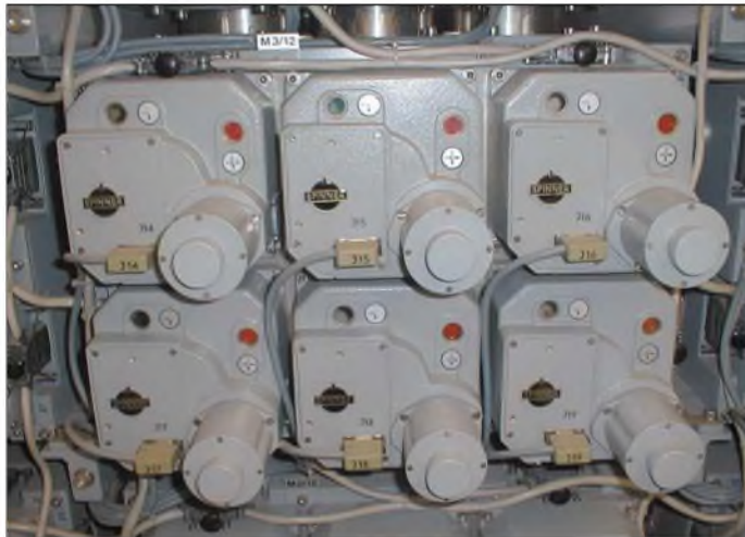
Durch eine massive Antennenmatrix in 50-Ω-Technik lassen sich die Signale der zwölf Sender auf insgesamt 42 Antennen schalten.
