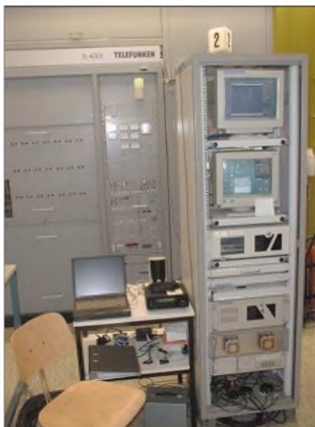
In diesem Teil der Anlage werden Sendungen in DRM-Technik aufbereitet und auf den Leistungsverstärker gegeben. Fotos: DL3PS (5), T-Systems (2)
