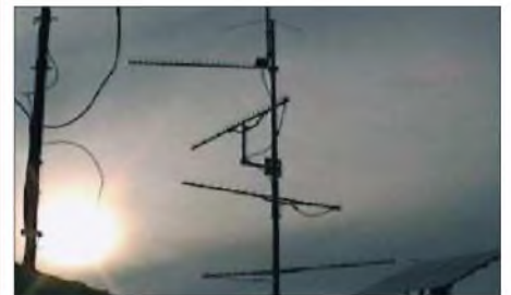
Linkantennen bei DB0ABB in München
