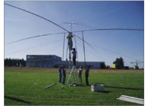
Antennenaufbau in Westerheim Fotos: P 41
