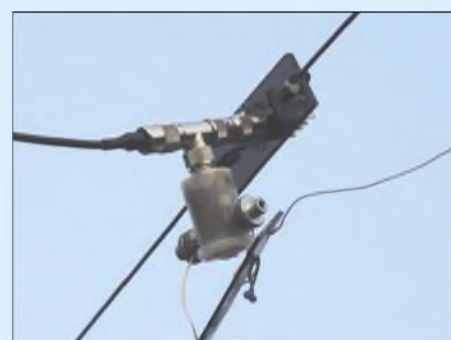
Bild 9: Hier ist der einfache Dipol mit einem weiteren, der über einen Balun verfügt, zu einem Multibanddipol verkoppelt.
