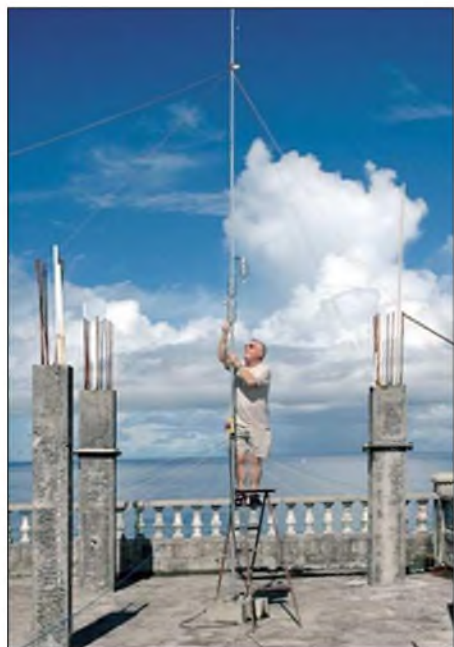
G3SXW beim Errichten der Vertikal auf Nauru
